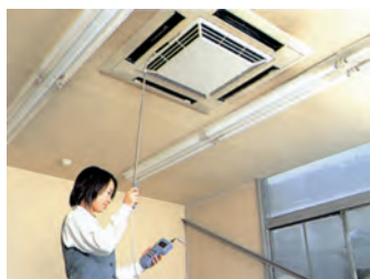
▲空調設備の点検
