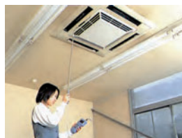
▲空調設備の点検
